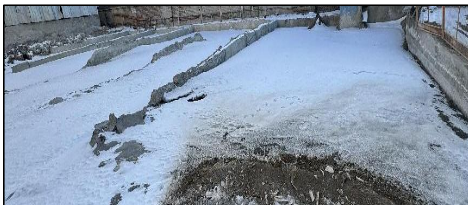
图 3-3 项目沉淀池现场照片
